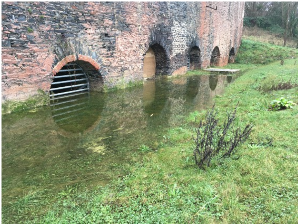
Inondation des fours de Bahais – janvier 2018
