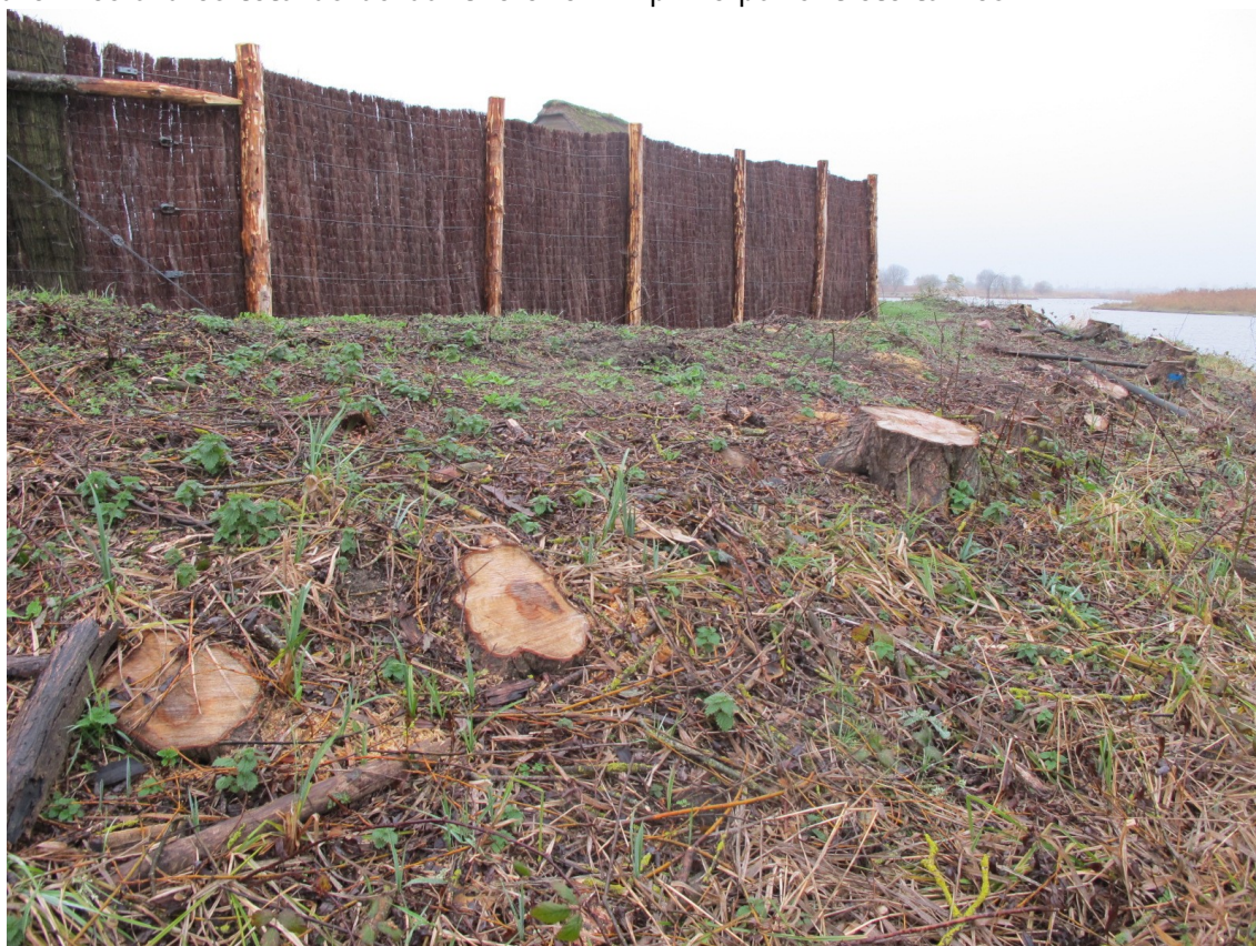
Recépage d'une haie de saule et pose de brande – ENS marais des ponts d'Ouve
